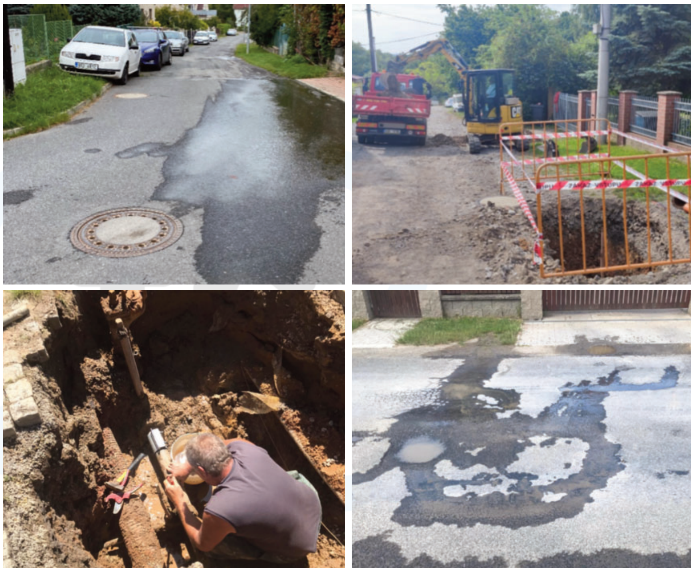
Obr. 5-7: Havárie na vodovodním řadu
